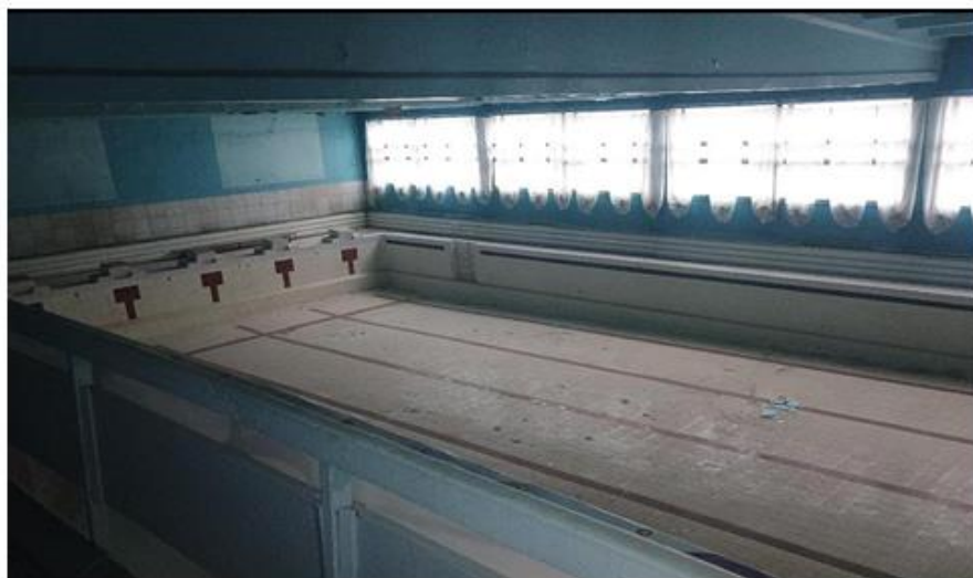
состояние до ремонта
