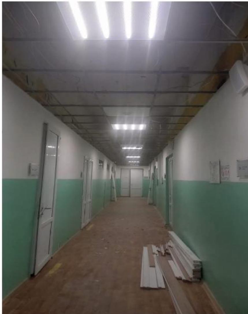
состояние до ремонта
