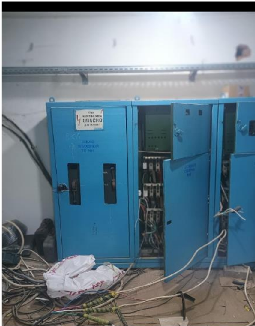
состояние до ремонта
